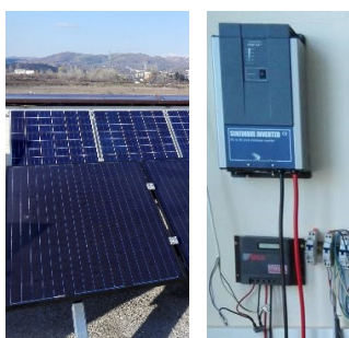
Fig. 4.4. Panoul PV ST220 și invertorul din cadrul sistemului hibrid "off-grid" 1PV
